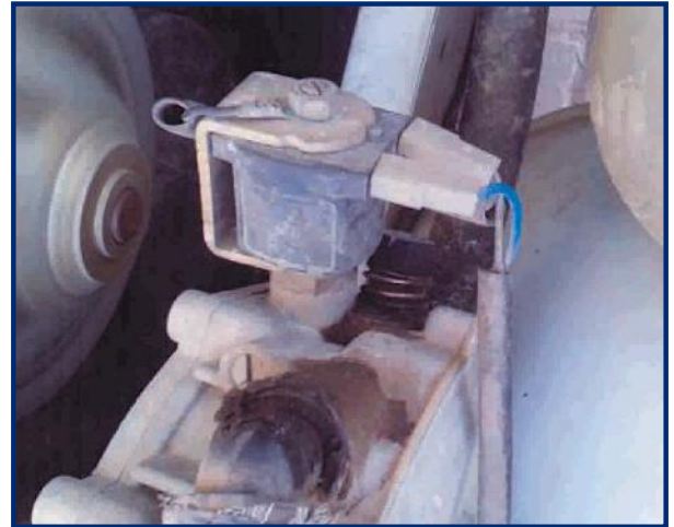
Regülatör ve bağlantılarında gaz kaçağı
